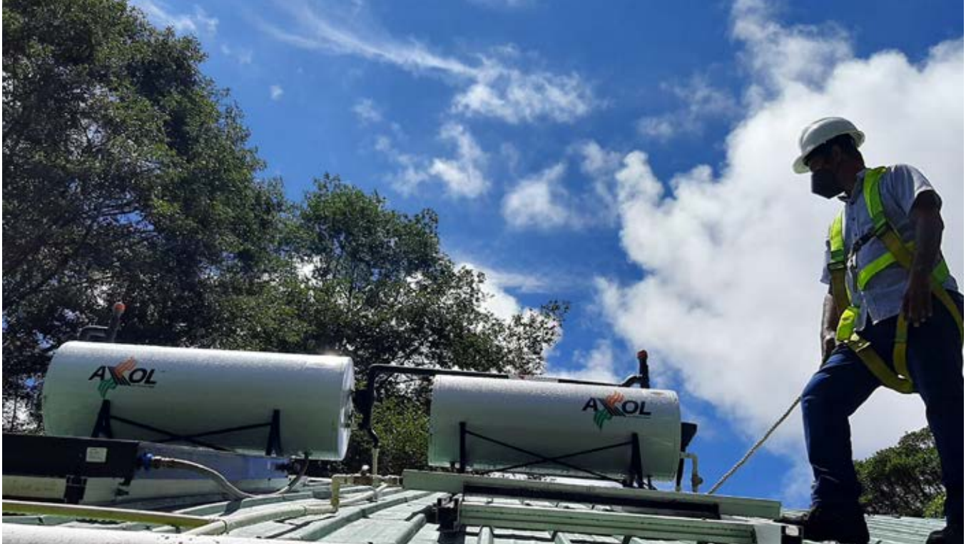
Foto: Termosolar Panamá
